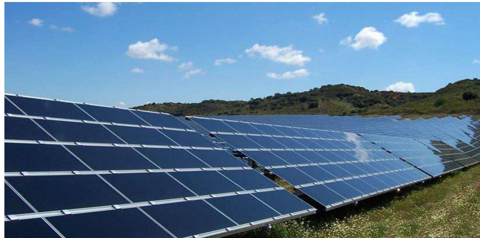
Parc photovoltaïque EDF Renouvelables de Narbonne
