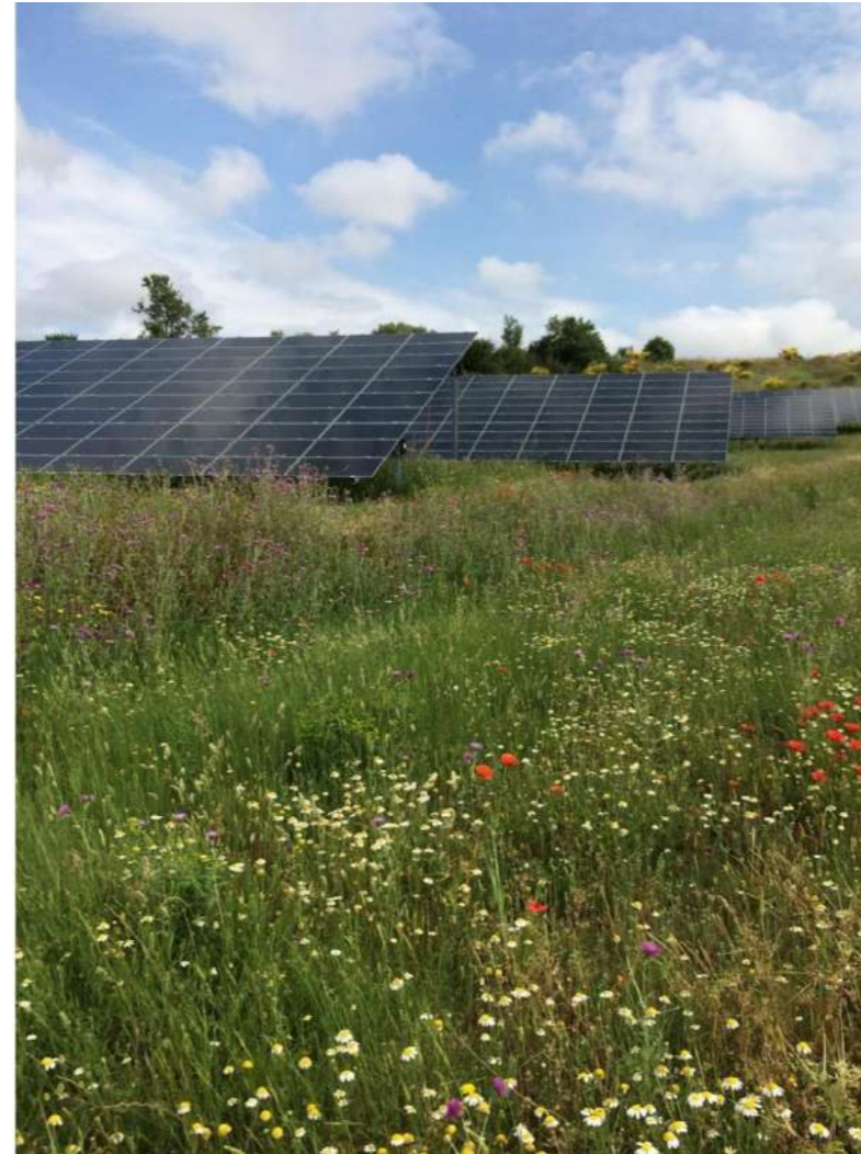
Parc photovoltaïque EDF Renewables de Narbonne (crédit photo EDF Renewables)
